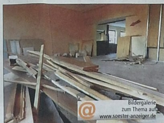
Wo jetzt noch Sperrmüll liegt, soll im kommenden Jahr ein Multifunktionsraum entstehen.
